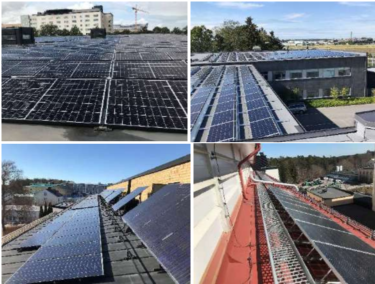
Några av Region Uppsalas Soleanläggningar omfattande totalt över 1500 kWp.
