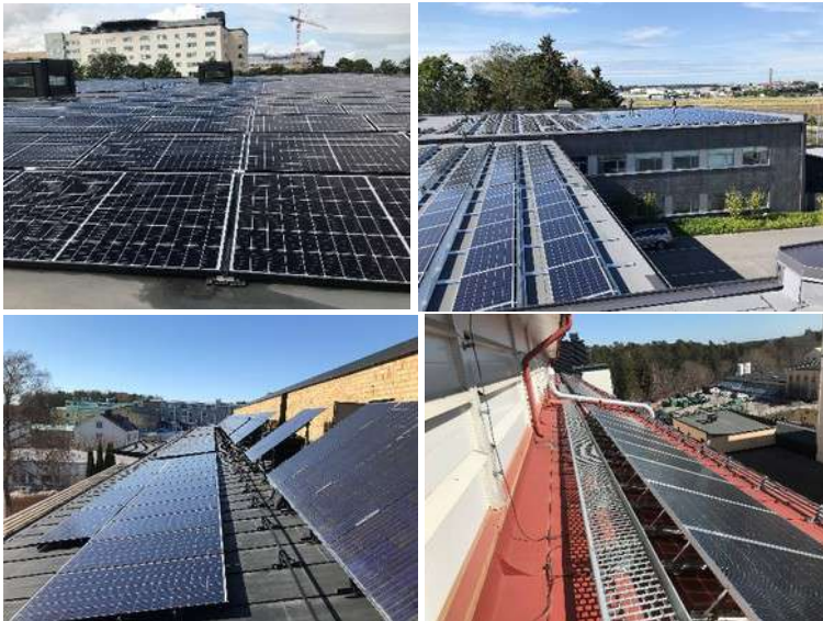
Några av Region Uppsalas Solelanläggningar omfattande totalt över 1500 kWp.
